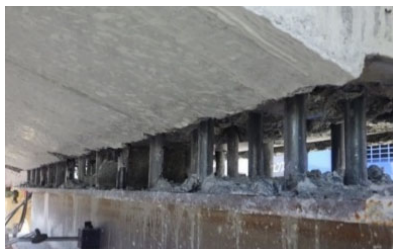
RC 床版の分離状況
